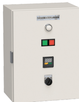
打たせ湯システム制御盤
